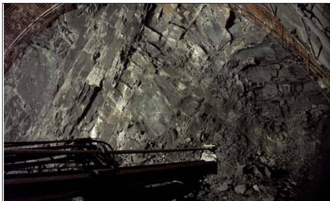
Obr. 4 Strmě uložené aleuropelity v čelbě kaloty s antiformní strukturou vpravo – tunelová trouba B, km 141,864 (foto Stach)
