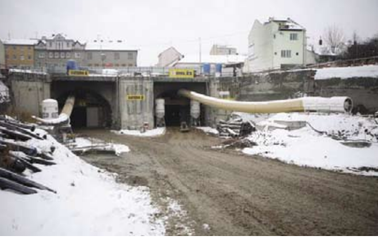
▲ Pohled na portál v Králově poli ukazuje, jak nízko je nadloží tunelů vůči městské zástavbě
