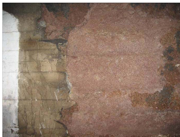
Příklad poškození ostění – povrchová degradace betonu
